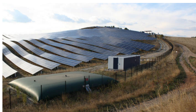
Centrale photovoltaïque sur 200 ha (Les Mées)
